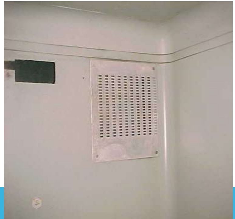
Exhaust fan arrangement
